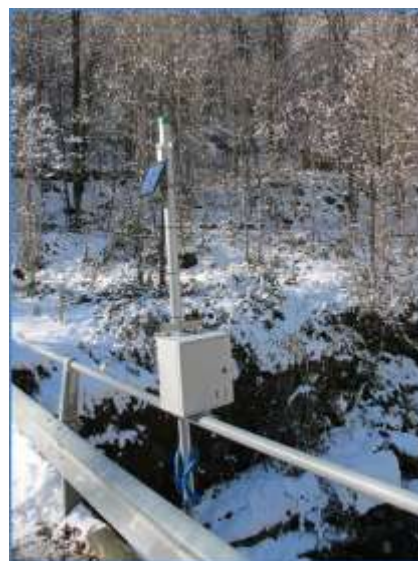
Installazione di datalogger con pannello solare
